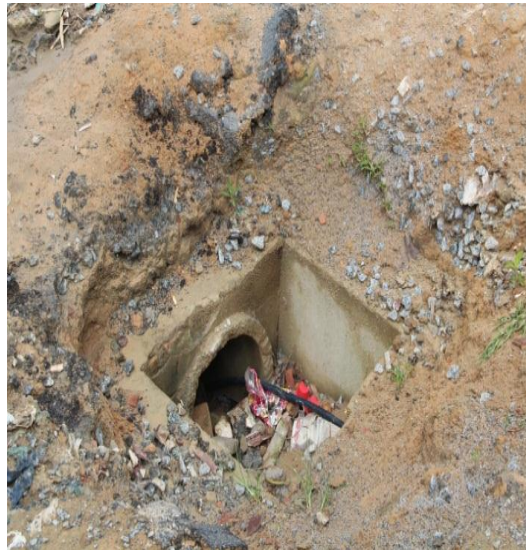
Situação dos bueiros encanamento de água e esgoto das vias
